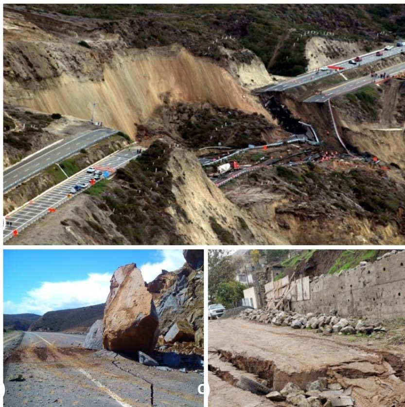
CASOS DE DESLIZAMIENTOS Y DESPRENDIMIENTOS DE ROCA EN EL MUNICIPIO DE ENSENADA. A) DESLIZAMIENTO EN TRAMO DE CARRETERA TIJUANA – ENSENADA, KM 93+50. FUENTE: AGENCIA REFORMA (2014). B) DESPRENDIMIENTO DE ROCAS EN CARRETERA LIBRAMIENTO NORTE. FUENTE: PROTECCIÓN CIVIL ENSENADA (2015). C) DESLIZAMIENTO EN LA COLONIA SEXTO AYUNTAMIENTO. FUENTE: CESPE (2019).
